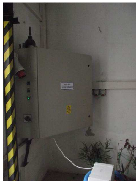
Kálvária-domb-i nyomásfokozó szivattyúk vezérlőszekrénye
