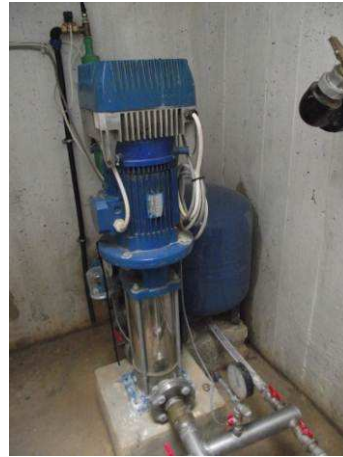
Barack utcai nyomásfokozó szivattyú
