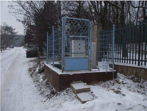
Barack utcai nyomásfokozó
