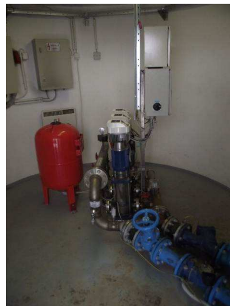
Séta utcai nyomásfokozó szivattyúk
