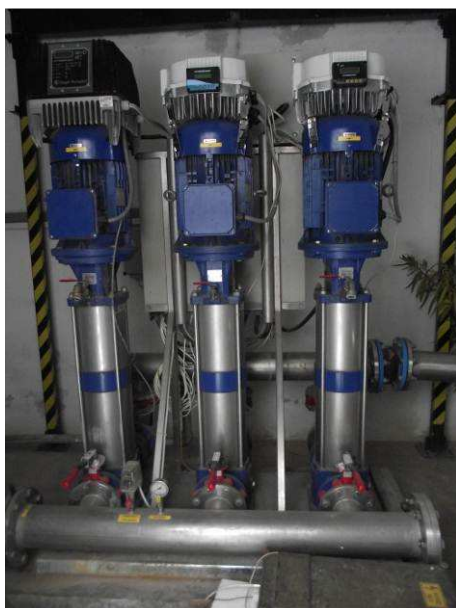
Kálvária-domb-i nyomásfokozó szivattyúk
