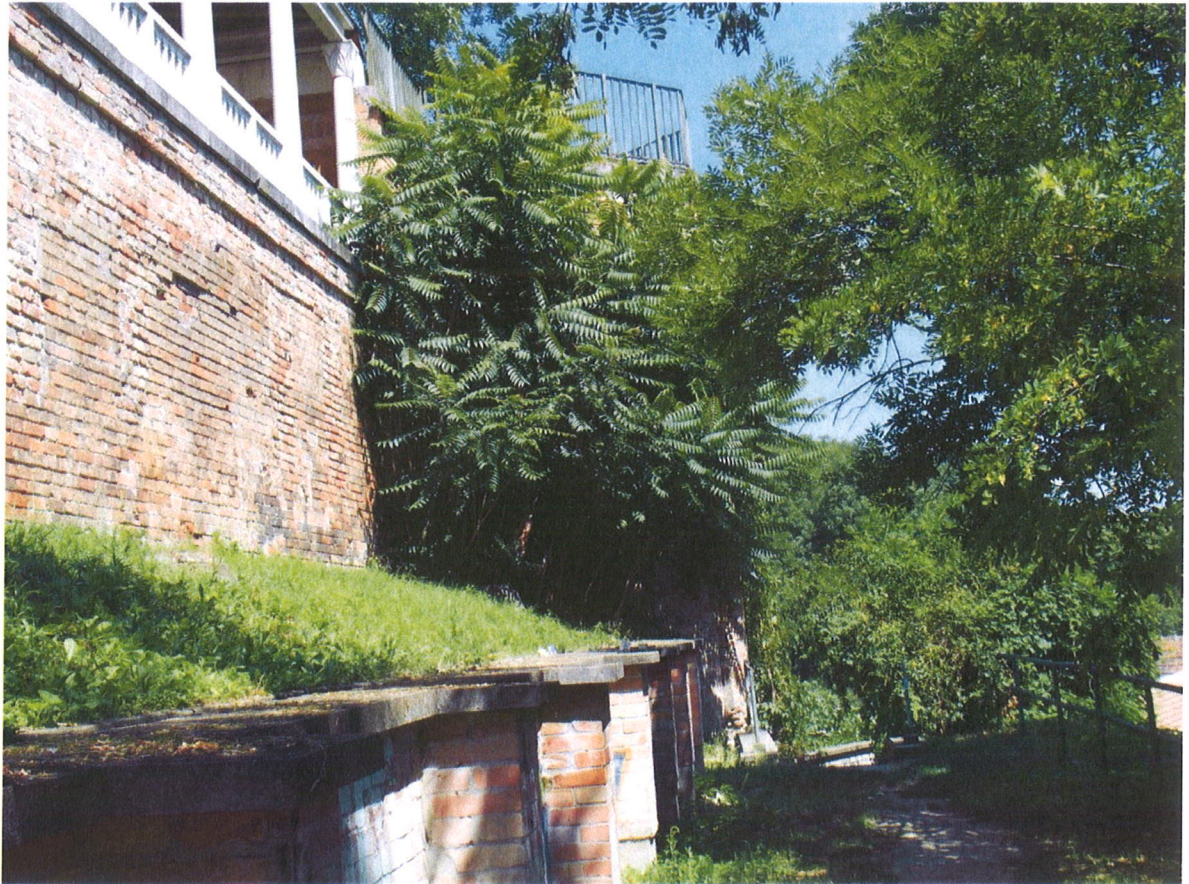
3.sz fénykép. Két támfal között megtelepedett bálványfa magoncok tömege
