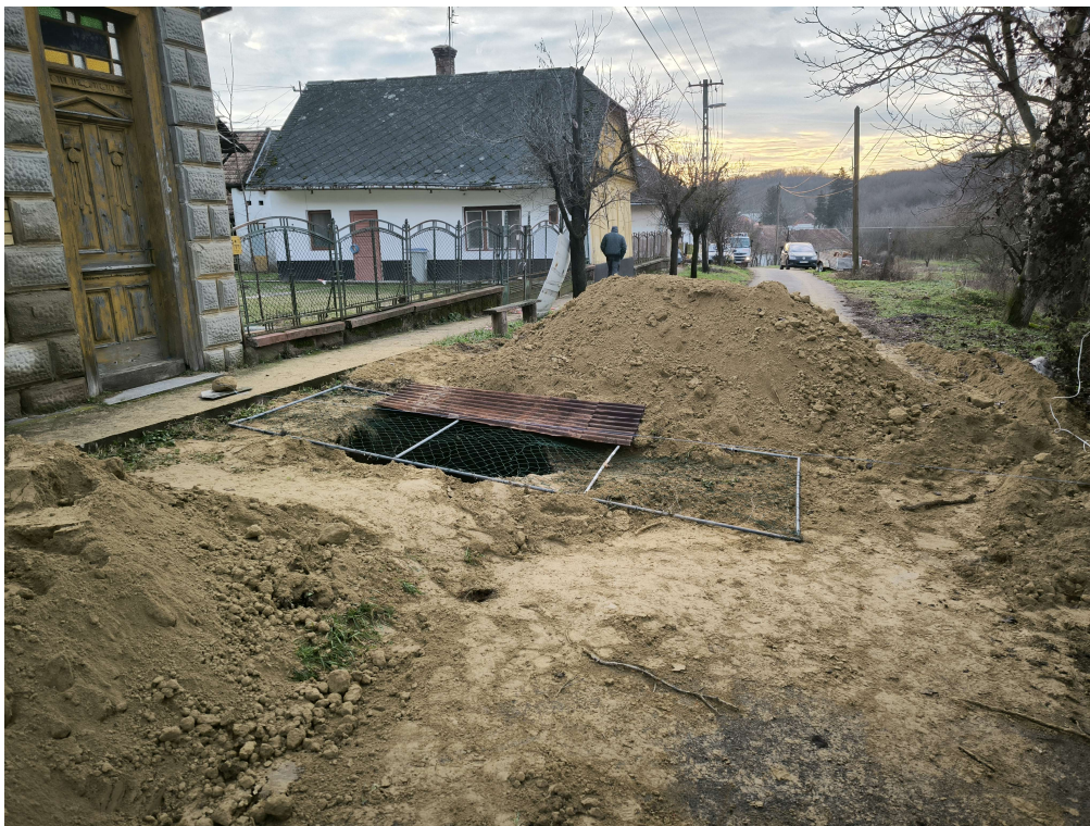
1.kép: A Damjanich u. 5. előtt kb. 2 m átmérőjű kürtővel beszakadt egy feledésbe merült pince a közút alatt. Az utat le kellett zárni. A szakadás körül a terepen nagy méretű horpa-, lefolyástalan terület alakult ki
