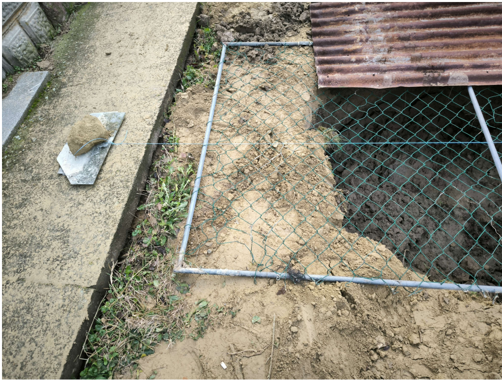
3.kép: A járda alatt is horpa keletkezett, a talaj lesüllyedt, a járdalemez elrepedt, az a levegőben lóg. A süllyedési mozgás a szakadás óta gyakorlatilag folyamatos. karácsonyra nem maradhat az út lezárva.
