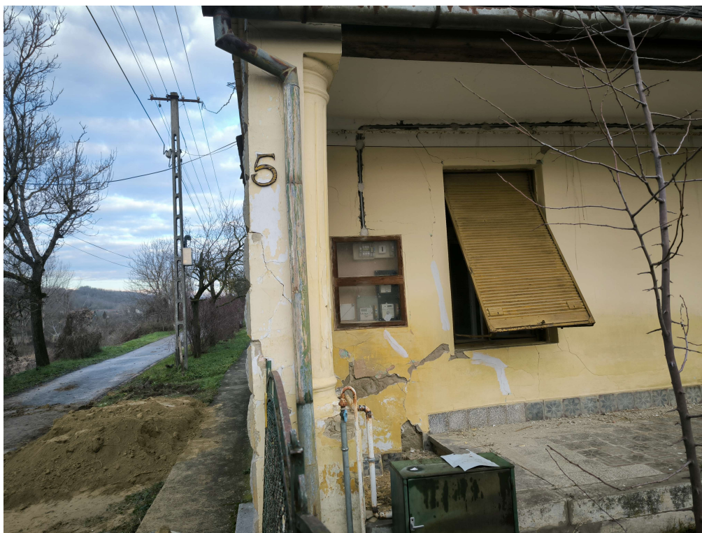
4.kép: A lakóház utcafronti főfala és a csatlakozó harántfalak összerepedeztek. A régebbi repedésekre helyezett gipsz- pogácsák is mind átrepedtek újból. Félő, hogy a homlokfal kidől az útra, emiatt ideiglenesen ki kell azt dúcolni.
