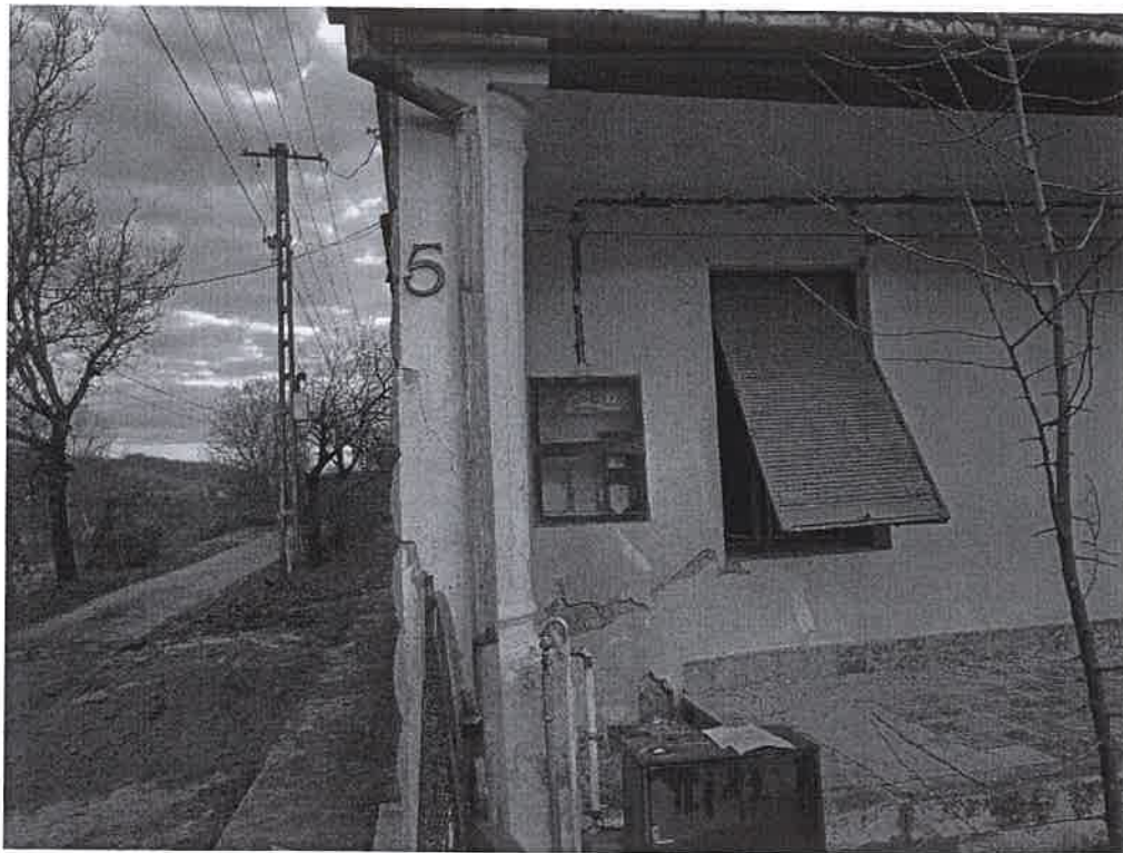
4.kép: A lakóház utcafronti főfala és a csatlakozó harántfalak összerepedeztek. A régebbi repedésekre helyezett gipsz- pogácsák is mind átrepedtek újból. Félő, hogy a homlokfal kidől az útra; emiatt ideiglenesen ki kell azt dúcolni.
