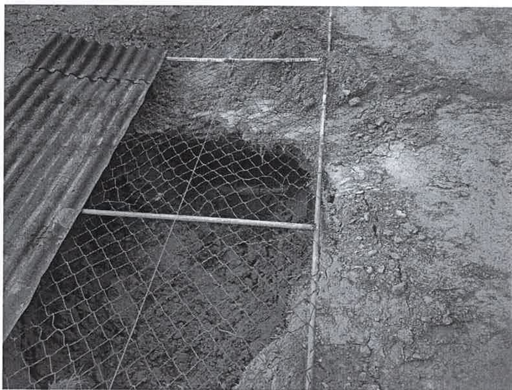
2.kép: A szakadásban a vízvezeték a levegőben lóg. A kürtő lefele tágul, a mérhető mélysége kb. 2,5 m. benne átázott omladék látható. A kürtő körül már repedések jelentek meg. A Karácsonyi Ünnepek miatt a kürtőt ideiglenesen vissza kell majd tölteni, a pályázat bírálatáig.
