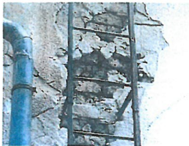
hibajelenség a homlokzaton
