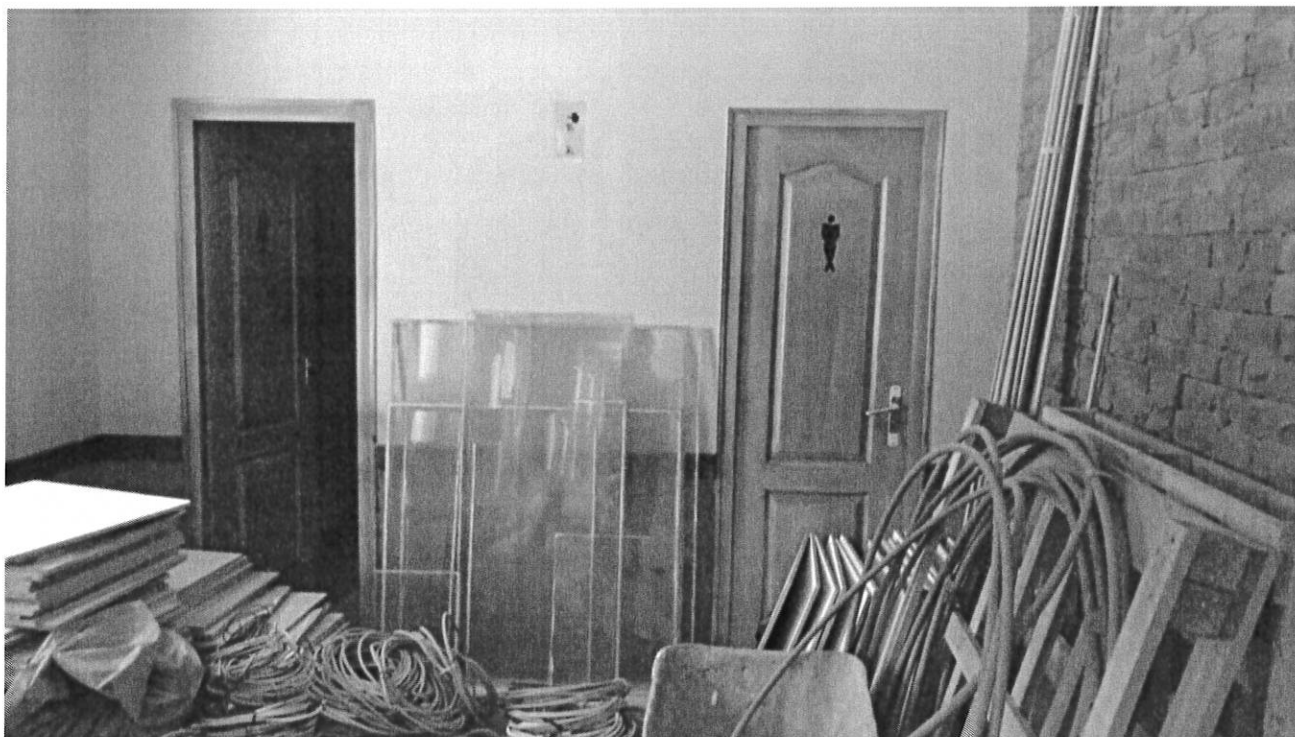
Vizesblokk WC 1.kép
