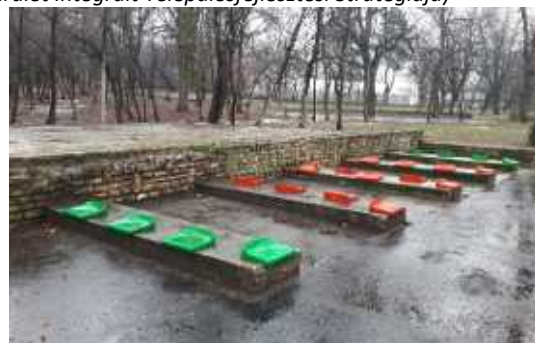
Degradálódott közterület a Csajkovszkij parkban
