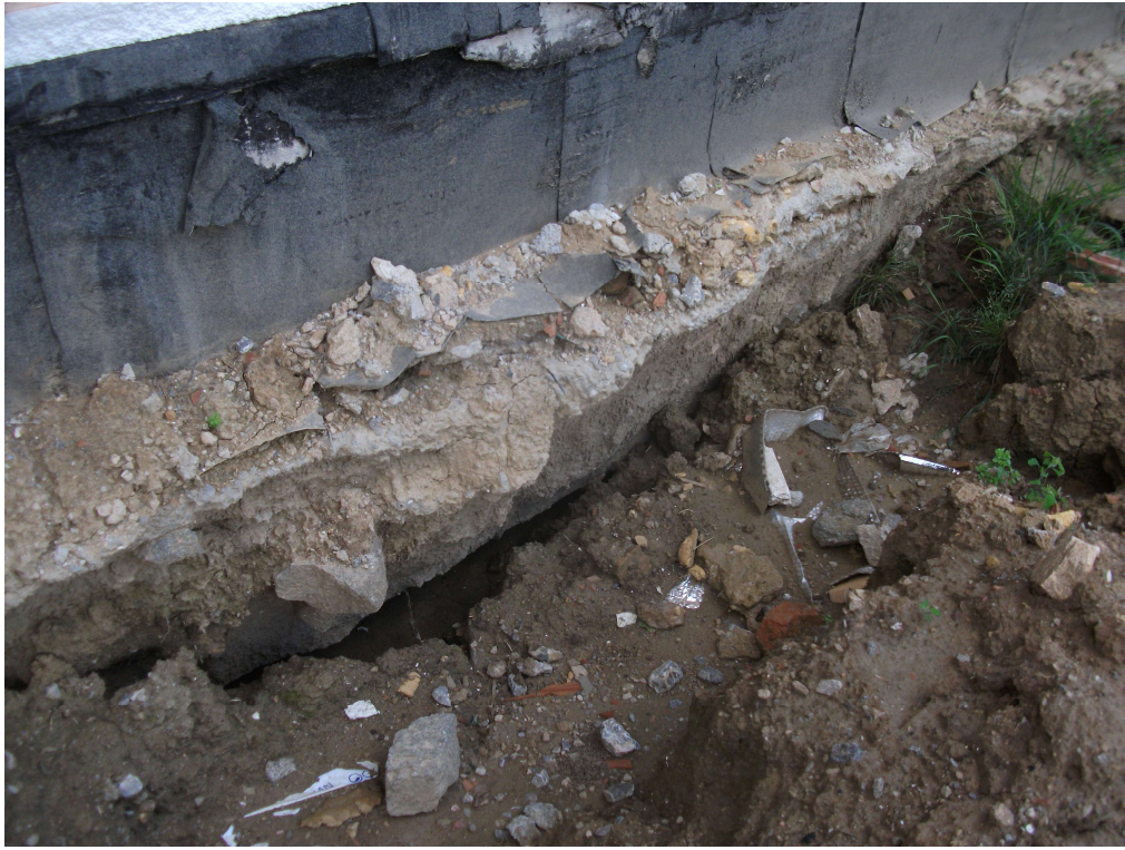
3.kép: Az üreg ferdén az épület alá „húz”, melyet feltárás után alá kell injektálni, illetve bányászati aknákkal kialakított pillérekkel is alá kell támasztani. Egyenlőre repedés még nem jelentkezett az alapokon és lábazon
