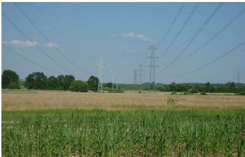
44. ábra: Pécs-Országhatár 400 kV-os szabadvezeték FENYŐ típusú oszlopokkal, vezetékfolyosó
