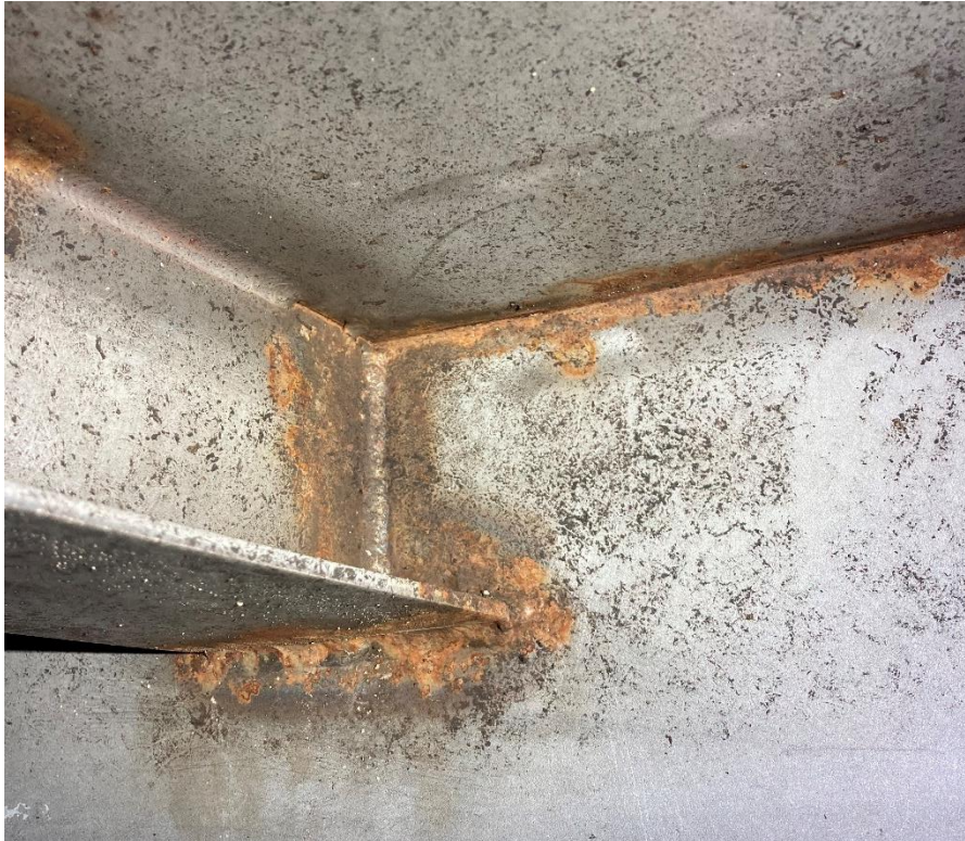
M1-5. ábra. Réskorrózió
