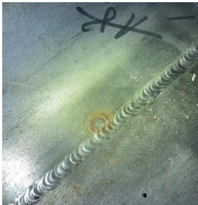
M1-6. ábra. Rozsdafolt az RA02B001 tartály fenéklemez varratán
