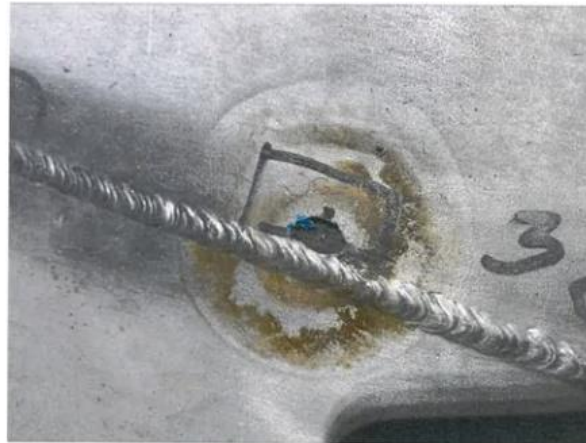
M2-3. ábra. Lyukkorrózió a RA02B001 tartály fenéklemez 38 sz. varratán
