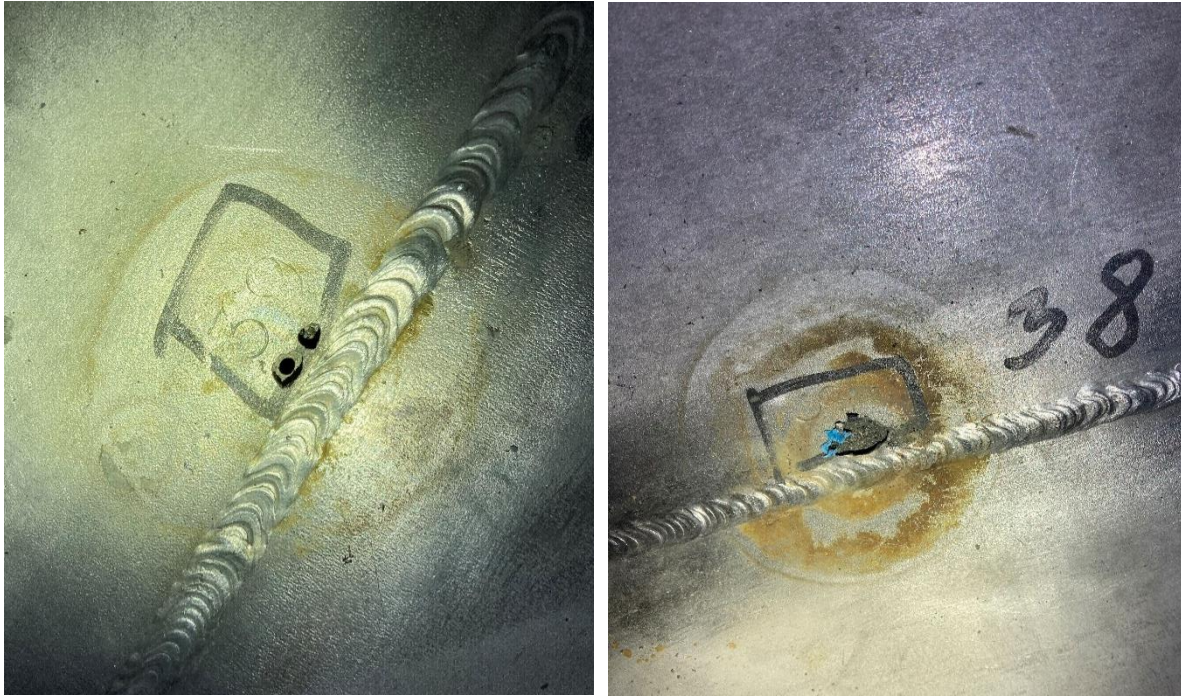
M1-3. ábra. Lyukkorróziós károsodások
