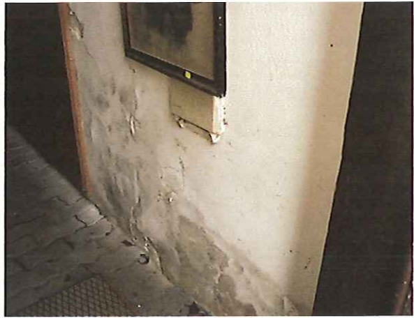
Ház oldala belső udvar vízszigetelés hiányossága
