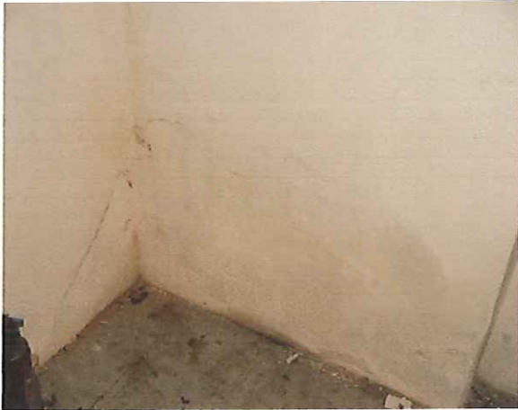
Üzlet vízszigetelés hiányossága
