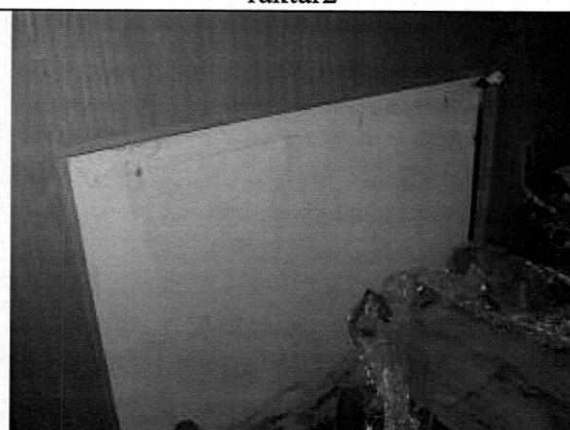
hiányzó radiátor (raktárak)
